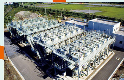
下水の高度処理施設
