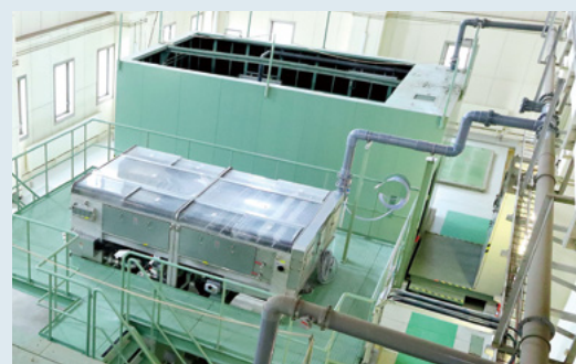
新設したベルト型汚泥濃縮機(手前)と既設の遠心型汚泥濃縮機(奥)
