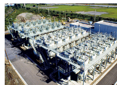
下水の高度処理施設
